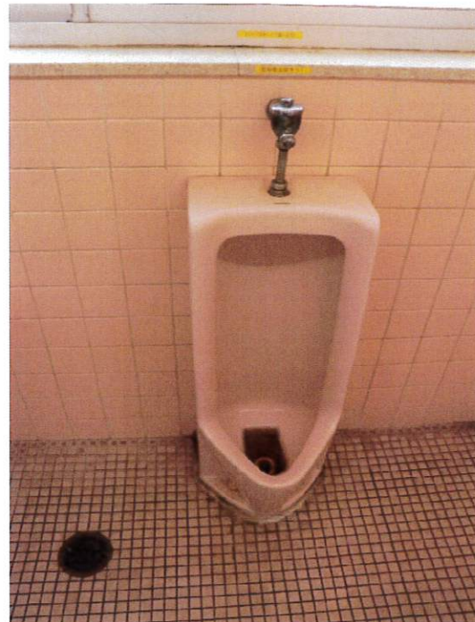
南館2階 トイレ小便器
