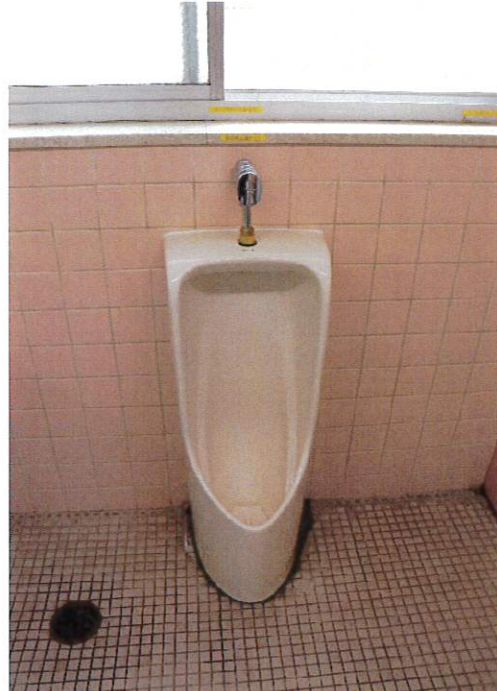
南館2階 トイレ小便器
